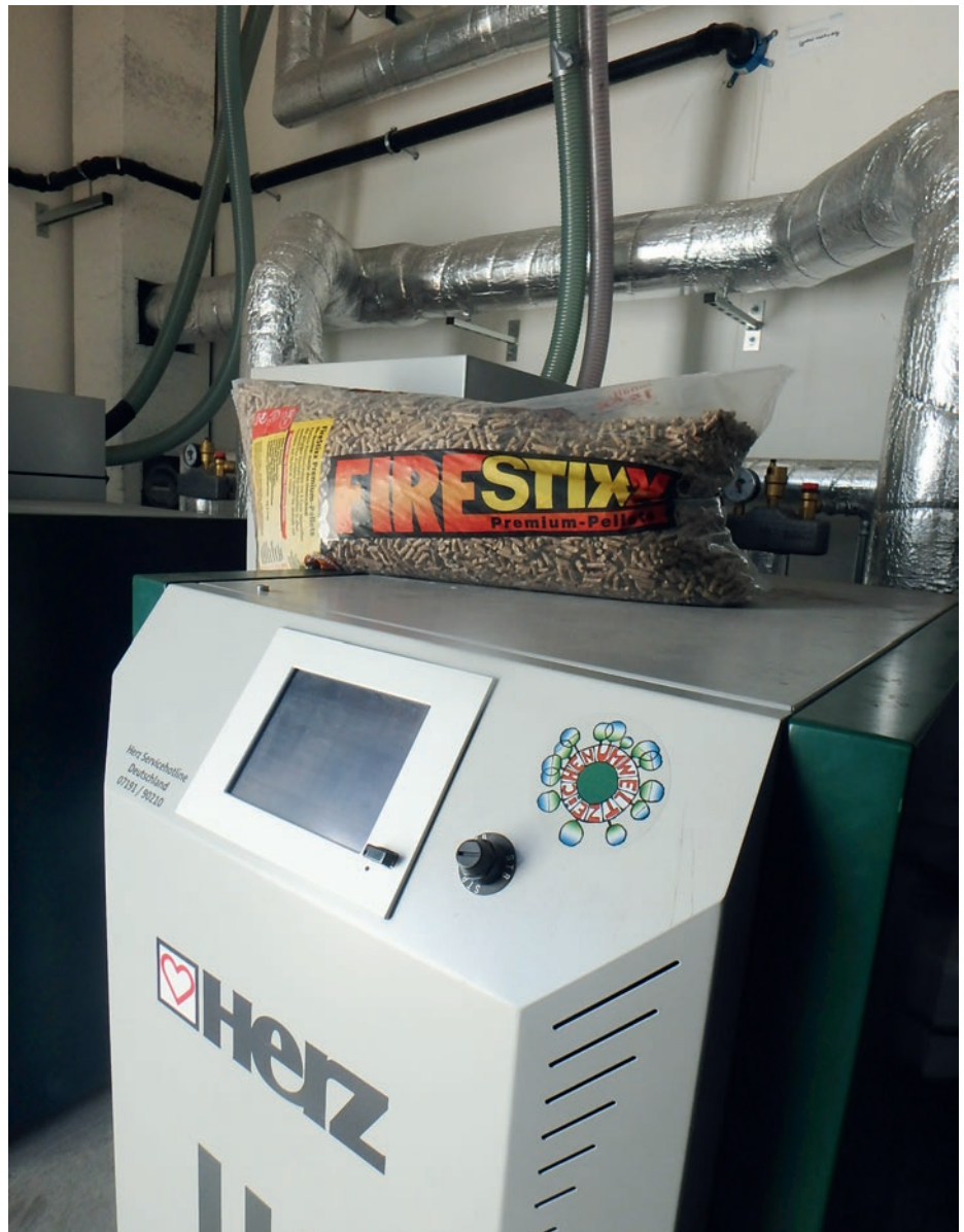
CO 2 -neutrale Heizung mit Pellets im Haus Galiläa, Teltow
