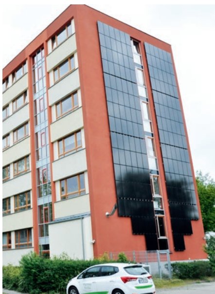
Photovoltaikanlage am Gesundheitszentrum Teltow
