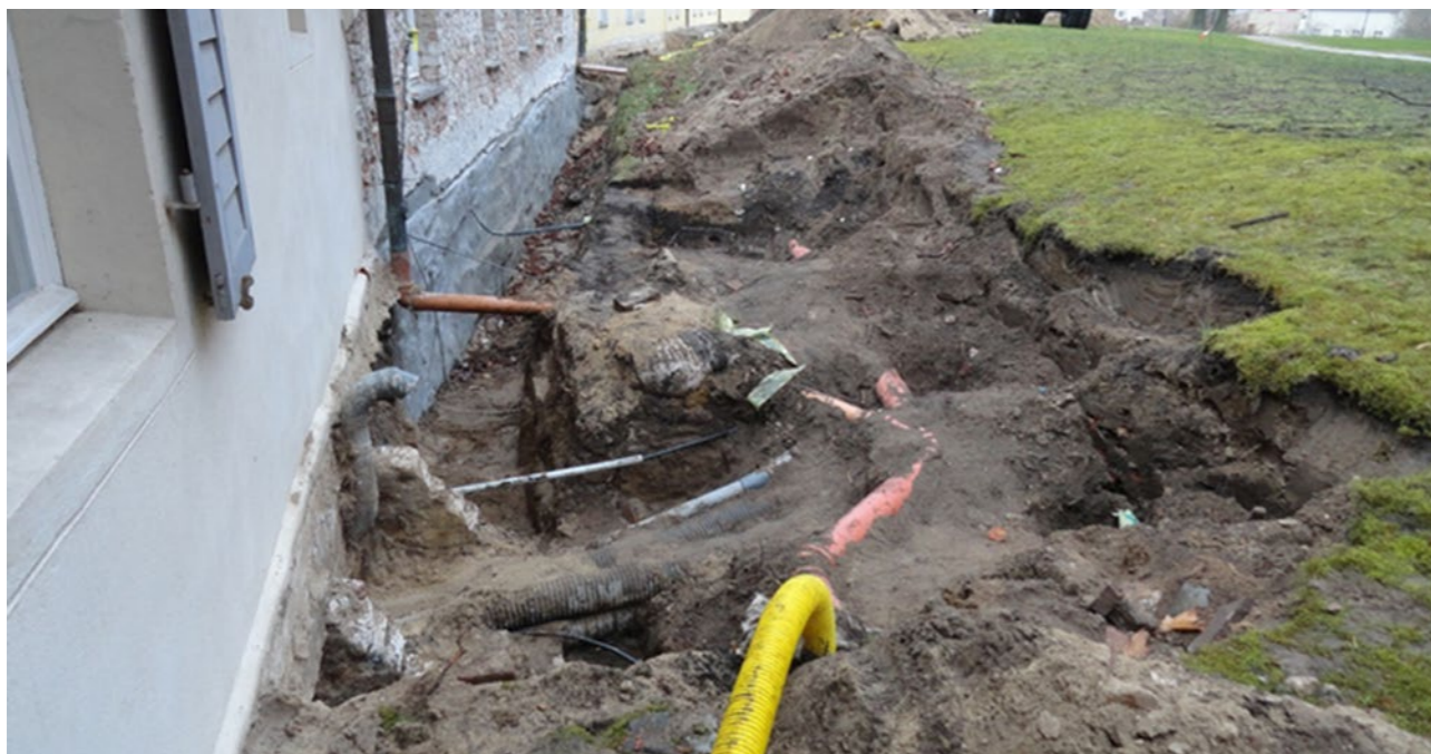
Zustand 2019 - die unsachgemäß verlegte Entwässerung verursachte Schäden am Elisabethhaus
